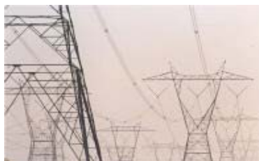
Figure 1 - Les lignes à 735 KV permettent de transporter le courant sur de très grandes distances. (Photo : Hydro-Québec) 2
